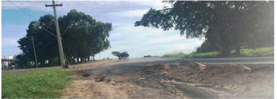
Parte ASFALTADA da SAÍDA do posto (direita acima) tem mão única e carros que saem da via (abaixo) tem que trafegar pela esquerda, pelo saibro e na conta-mão – um perigo
