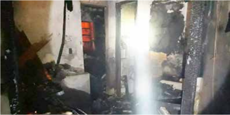
Parte do imóvel ficou destruído após incêndio (FOTO: Divulgação Whatsapp)
