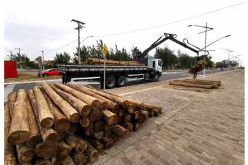
Passarelas sendo construídas junto à Praia Grande: um dos projetos com recursos do Badesul
