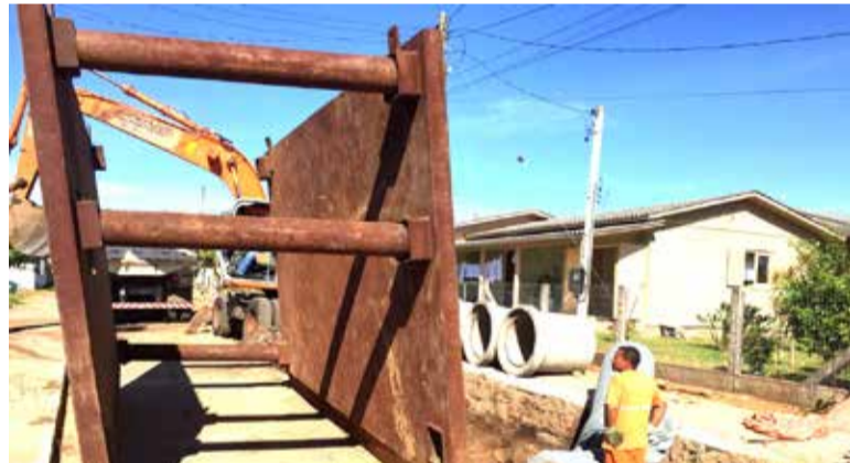
Drenagem na Vila São João é outra obra com recursos do Badesul
