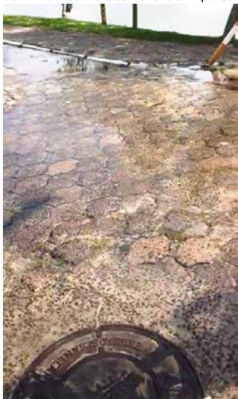
Problema em bueiro registrado sábado na Lagoa do Violão (imagens de Torricasurfcheck)
