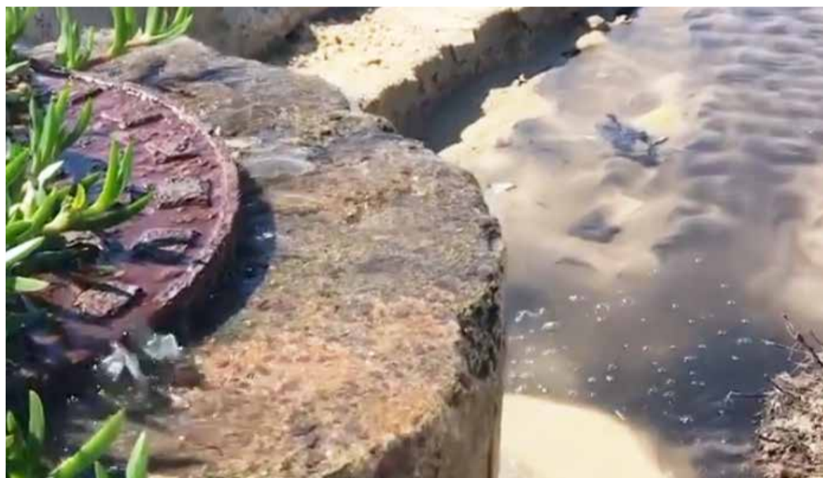
Bueiro que na segunda-feira (17) transbordava esgoto na Praia da Cal
