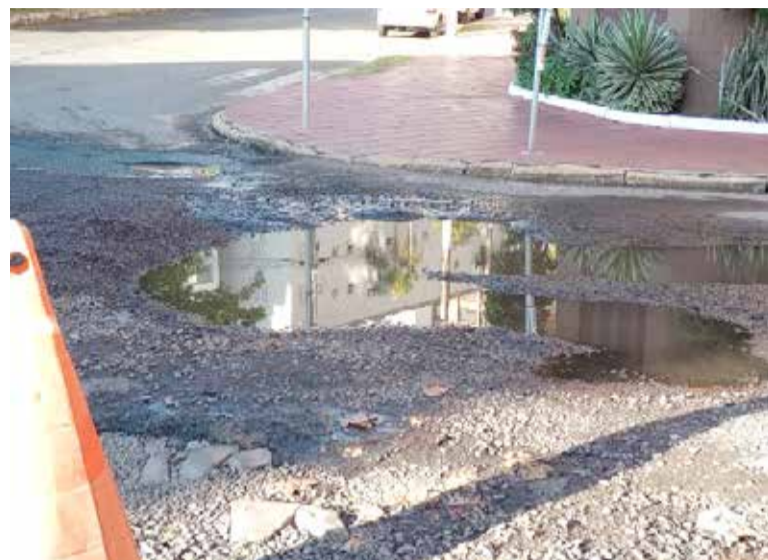
Buraco na esquina da Rua Desembargador Vieira Pires com a 7 de Setembro (por Angelin Photos)
