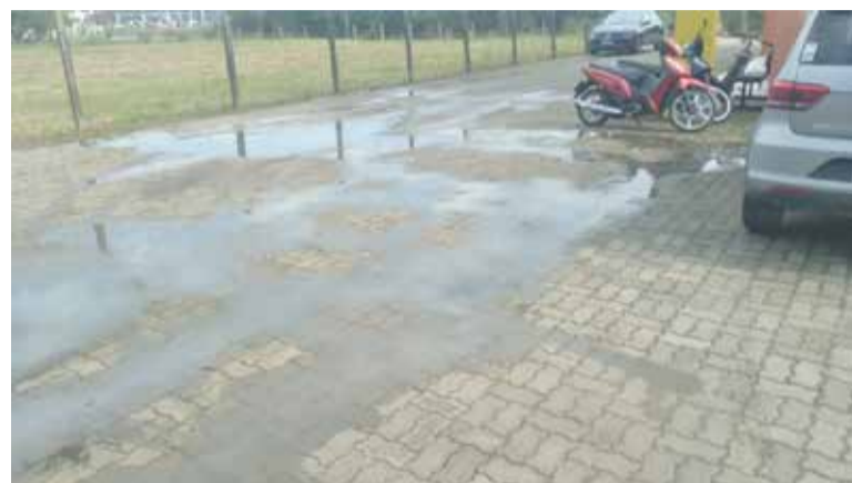
Esgoto in natura corre pelo pátio do estabelecimento de ensino municipal; vereadores reclamam falta de atitude da municipalidade
