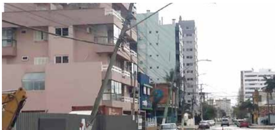
No Centro de Torres, alguns postes com risco de queda após vendaval
