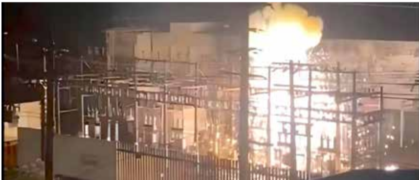
Imagem do momento do estouro na subestação de Torres
