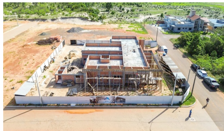
de ambientes planejados para garantir conforto tanto aos usuários quanto às equipes de saúde. (FONTE – Ascom PMPT)
