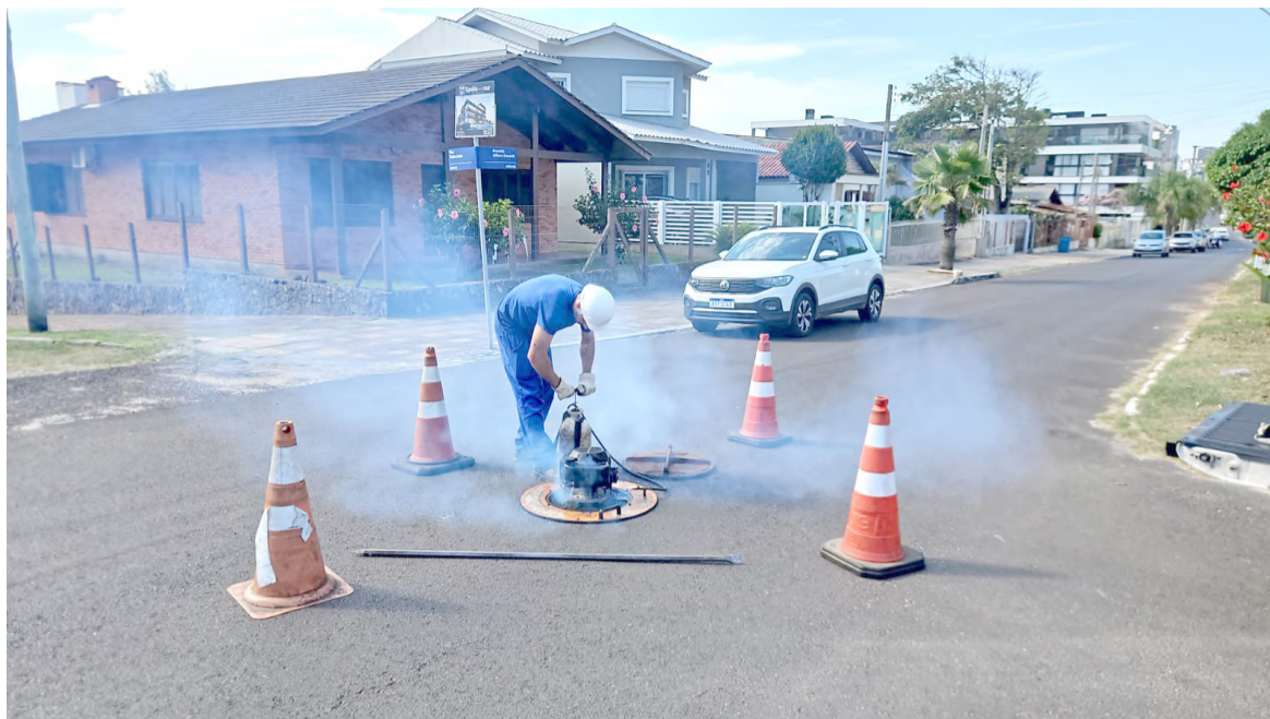
Vistorias nas redes de esgoto são feitas por método conhecido como ‘fumacê’
