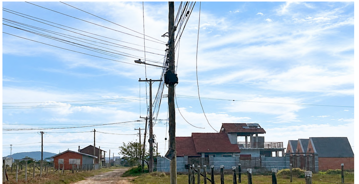
Trecho da rede elétrica atingido pelo furto (Foto: Divulgação/CEEE Equatorial)
